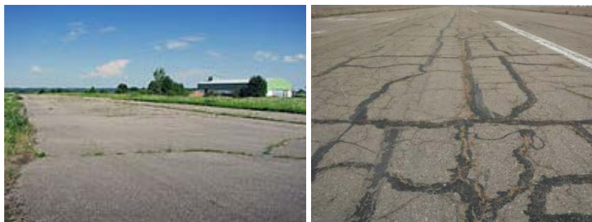
Рис.1. Приклади руйнувань аеродромного покриття
